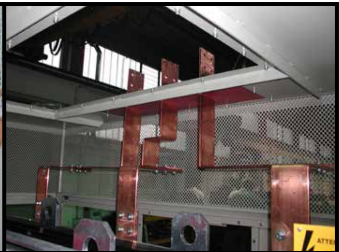
Присоединения НН на крыше кожуха
