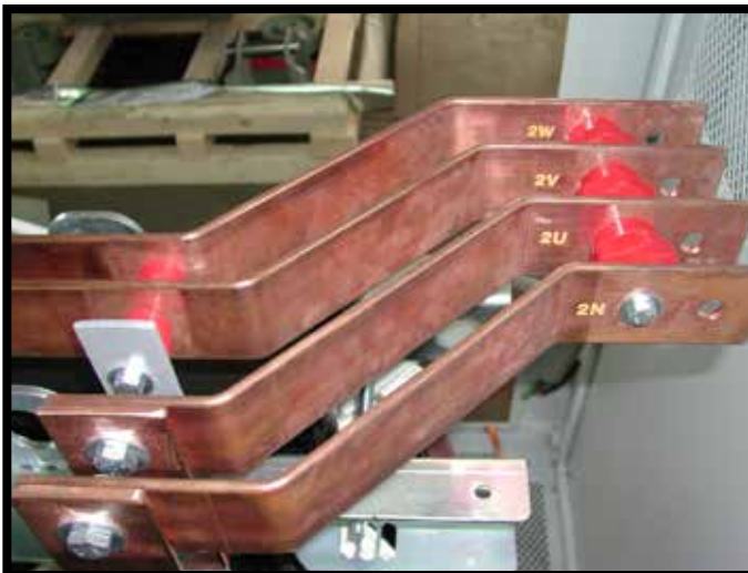
Присоединения НН на левой стороне трансформатора
