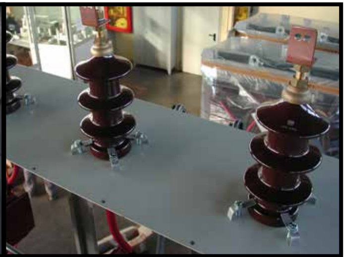
Присоединения ВН на крыше
