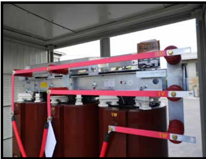
Присоединения ВН на правой стороне трансформатора
